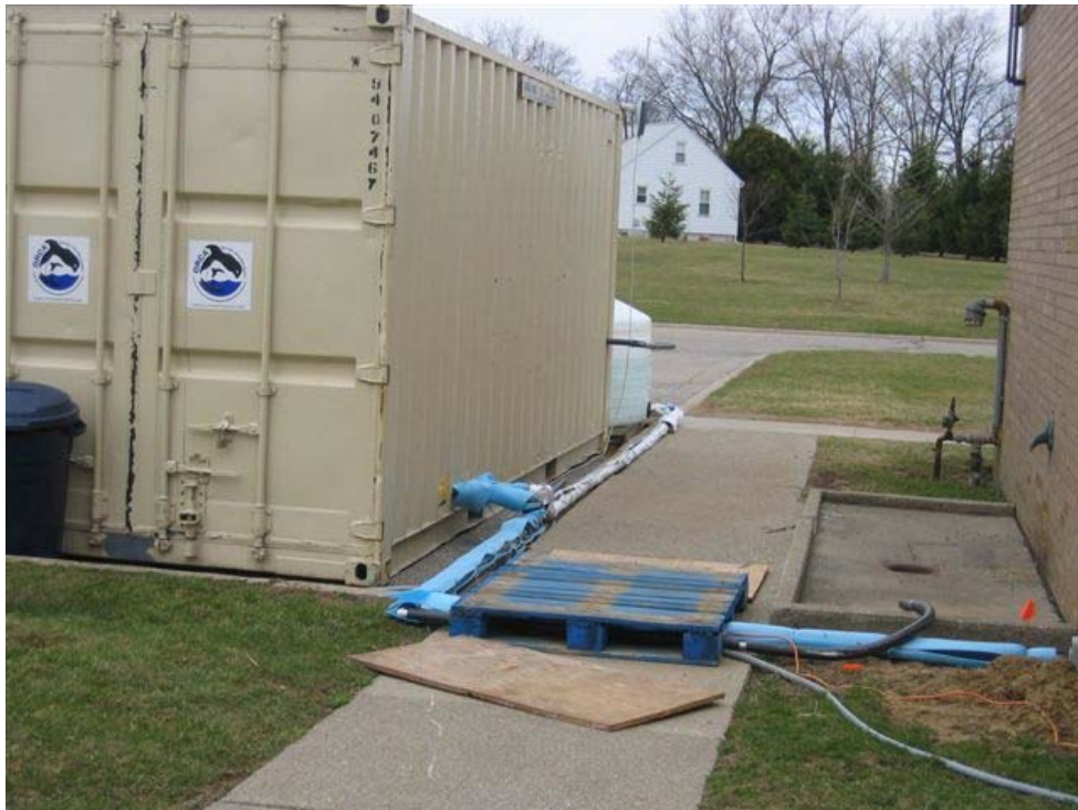
Planta de 10,000 lts/horar instalada dentro de un contenedor convencional de 20 pies
